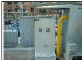
Cassetta Interruttore generale
