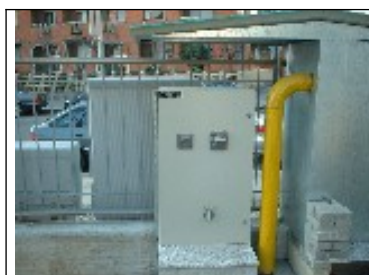
Cassetta Interruttore generale
