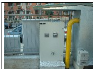
Cassetta Interruttore generale
